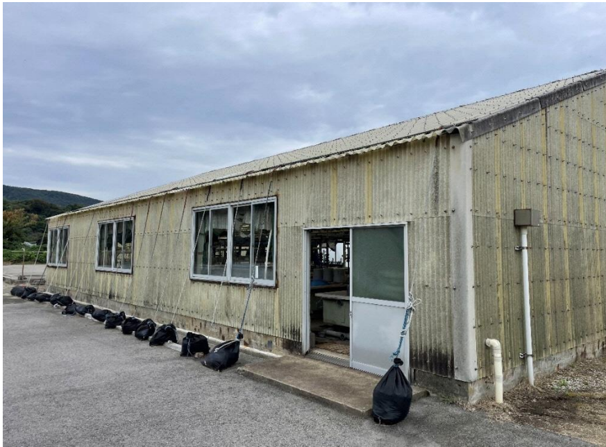
応急措置でしのいでいる餌料馴致棟
